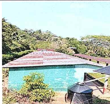
Foto 4: se necesita pintar el edificio
