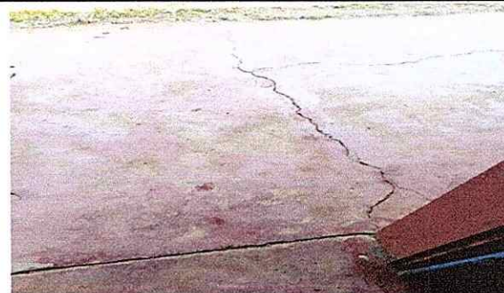
Foto 6: se observa daños en el piso del edificio
