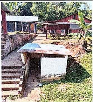
Foto 3: Se observa el deterioro de lamina e instalacion de puerta del baño
